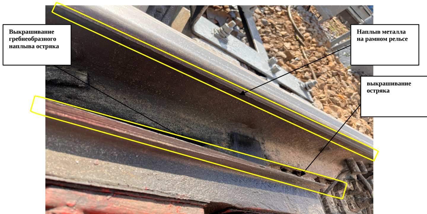
Рис.3. Наплыв металла по рабочей грани остряка, выкрашивание остряка, наплыв металла на рамном рельсе (вид укрупненно)
