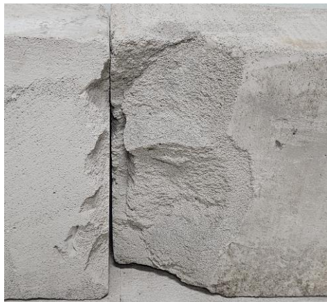
Исходное состояние. Разрушение футеровки.
