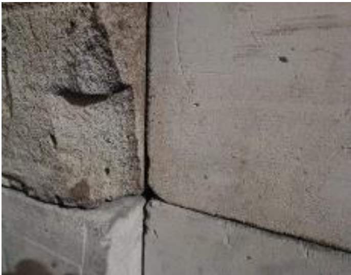
Исходное состояние Разрушение футеровки
